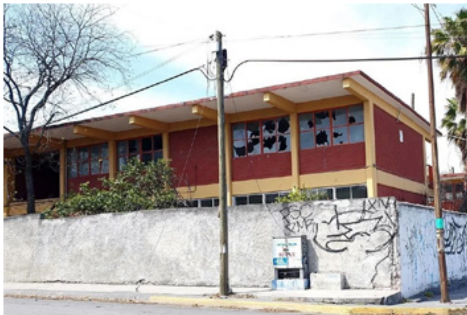
Imagen: "Envejecen escuelas; falta mantenimiento" en https://www.mural.com.mx/envejecen-escuelas-falta-mantenimiento/ar2309879
